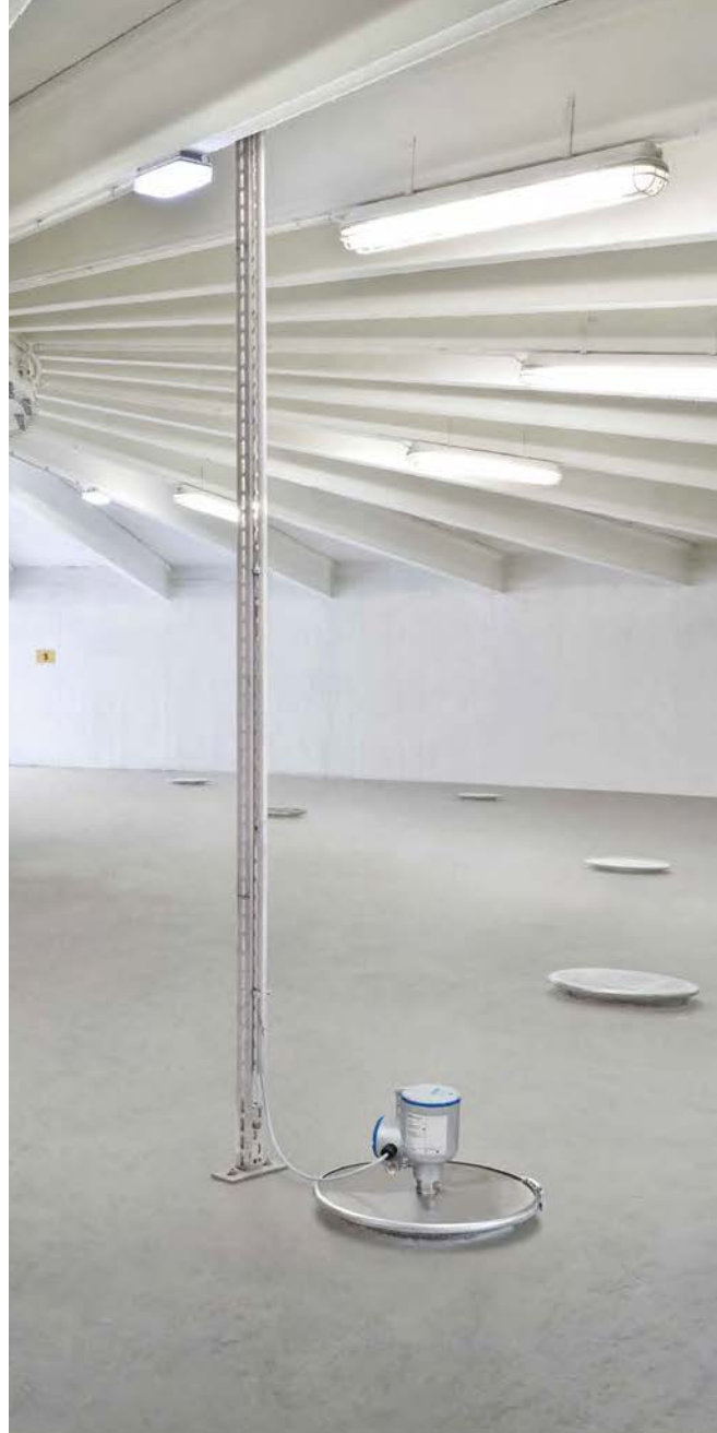
OPTIWAVE 6400 C на элеваторе, заполненном семенами горчицы при температуре окружающей среды и атмосферном давлении
