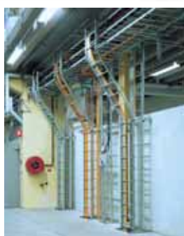
Кабельные лестницы и лотки
