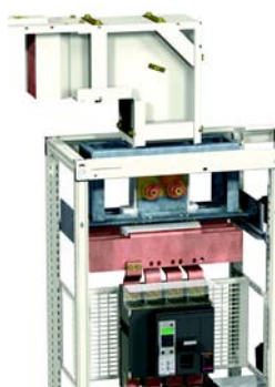
Прямое подключение шинпровода Canalys KT к автоматическому выключателю Masterpact 3200 A
